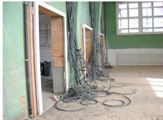
Installationen Aula 2.OG
