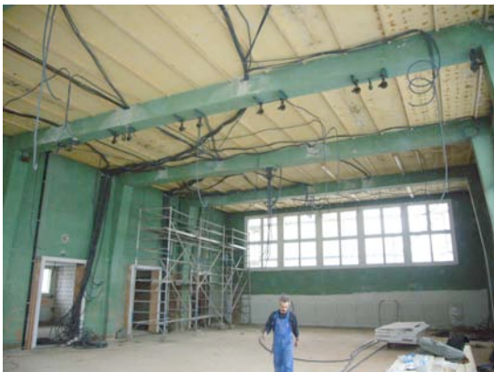
Installationen Aula 2.OG
